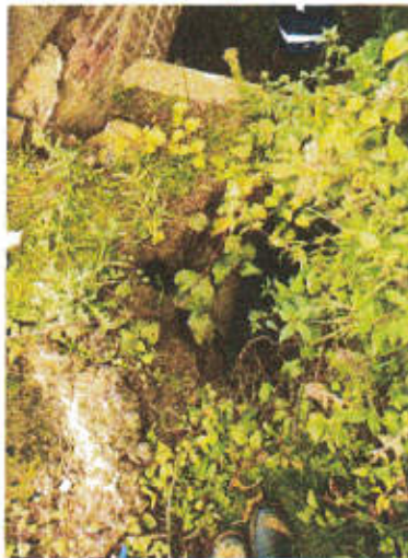
Busage évacuation eau pluviale rompu
